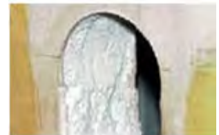
Fire retardant door insulation (friable)
